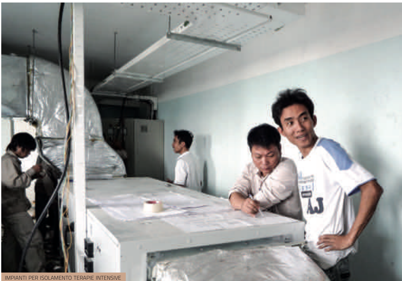
IMPIANTI PER ISOLAMENTO TERAPIE INTENSIVE
